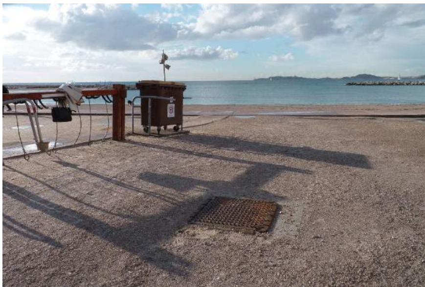
Chambre d'atterrissement du câbles AAE-1 dans son environnement balnéaire.
