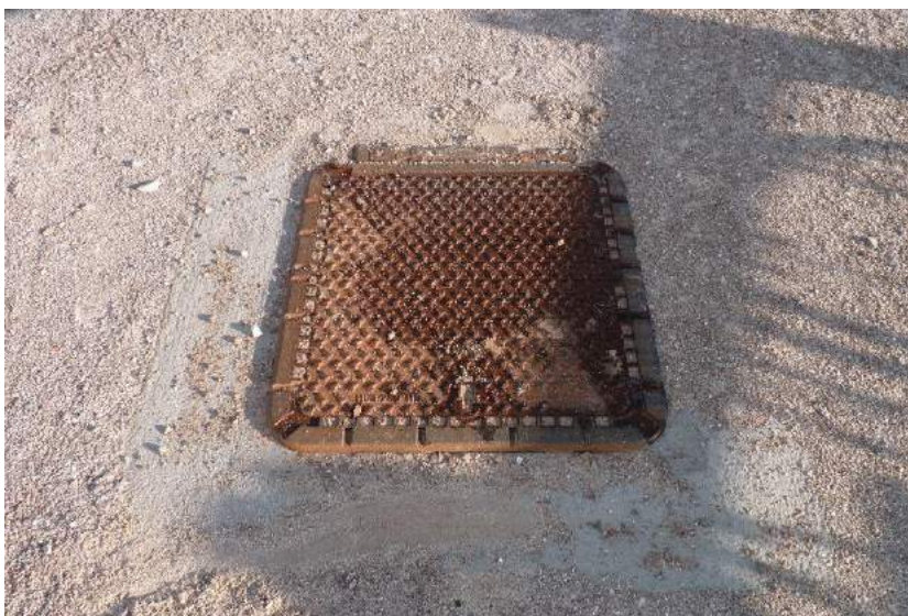
Entrée de la chambre d'atterrissement du câble AAE-1
