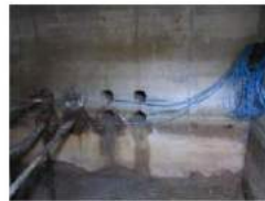
Figure 2 : Vue intérieure d'une chambre-plage (Orange Marine)
